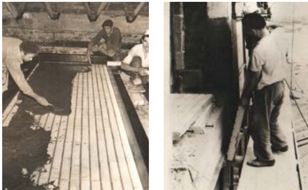
Сл. 3 / Израда и монтажа фасадног панела са облојом од керамичких плочица на објекту Б9 у Блоку 21, 1965. (Lenačić, Gavrilović)
